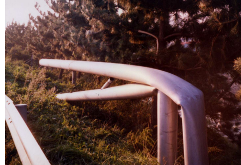
그림 2 남해고속도로 표지판의 수직재의 좌굴전도
