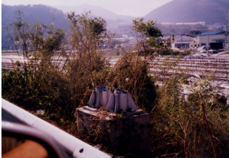
그림 1 남해고속도로 문형식표지판의 수직재 하단 리브부 파괴
