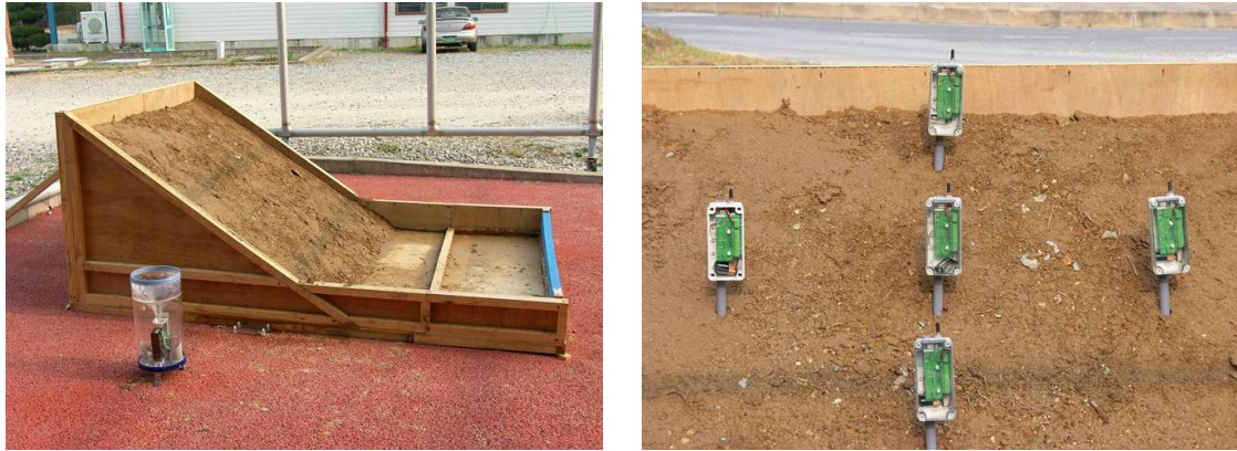
(a) 인공사면 (b) 센서노드 설치 전경 그림 2. 인공사면 실험: (a) 인공사면; (b) 센서노드 설치 전경
