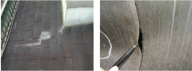
사진 1. 시트공법의 접합부 하자사례
