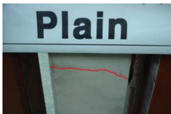
균열 발생일 : 37일
