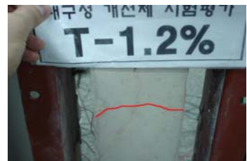
균열 발생일 : 24일
