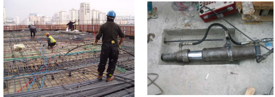
(a) 철근 및 긴장재 배치 현장 (b) 상향 긴장 방식의 적용 그림 2. 상향긴장식 부분PT구조의 현장적용
