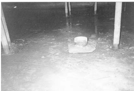
그림 7 강연선이 부식 파단한 부력방지 영구앵커 두부 상태(두부캡 개봉전)
