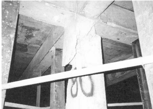
그림 9 부력방지 영구앵커의 강연선이 부식·파단하므로써 부력에 의한 기둥의 압축력이 증가하여 좌굴 파괴된 상태
