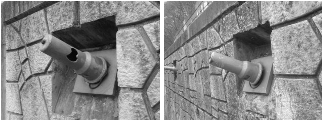
그림 11 캡의 파손이 발생사례 및 캡의 이완에 따라 캡의 기능을 상실한 사례
