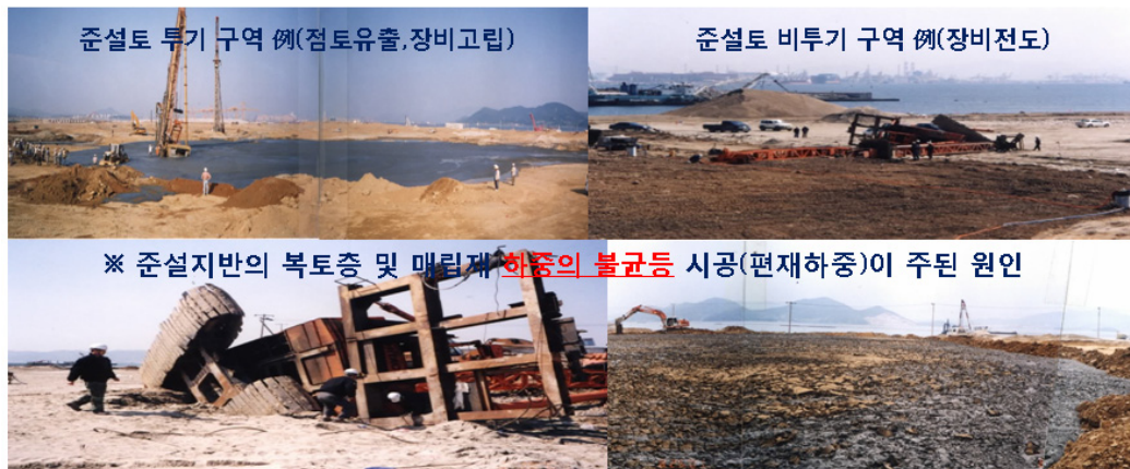
그림 2. 연약지반 개량 시공 중 지반의 파괴 및 장비의 전도 예
