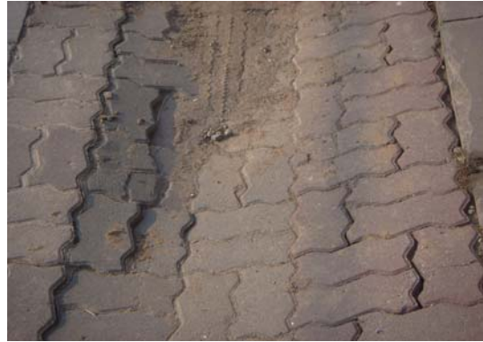
(d) 중차량에 의한 파손
