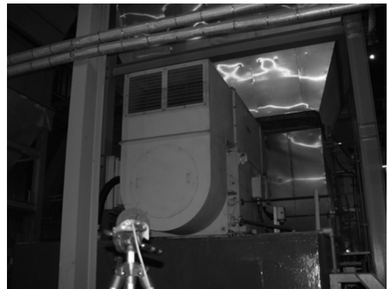
(b) Booster fan motor
