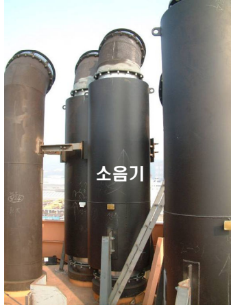
Figure 8 공명형 소음기 설치 모습 (연돌 상부)
