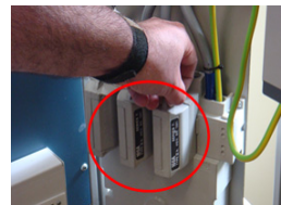
(a) 퓨즈 설치 사진
