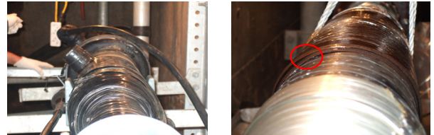
〈그림 1〉 케이블 절연 접속부 회전 및 변형 상태
