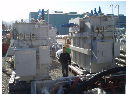
〈그림 3〉 10MVA STATCOM용 변압기
