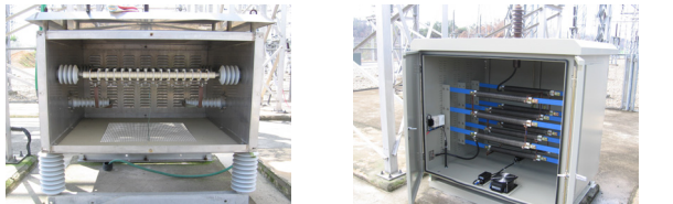
(a) 개선전 중성점 저항기 (b) 개선후 중성점 저항기
