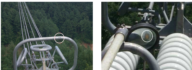
〈그림 2〉 낙뢰로 인한 765kV 애자장치 섬락고장
