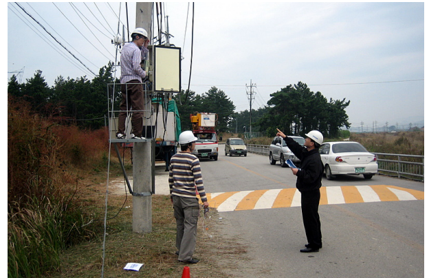
<그림 5> 고창전력시험센터 배전시험장 남선 18번에 MASX 장치 설치
