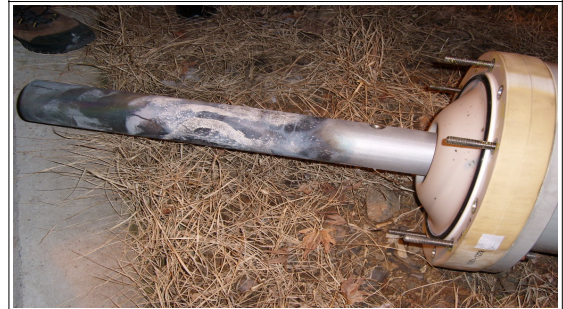
AA-BB#2T/L 인출 Wall bushing 도체 접속부( 아크 흔적 )
