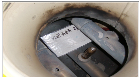
AA-BB#2T/L 인출 Wall bushing 도체와 외함간 아크 흔적
