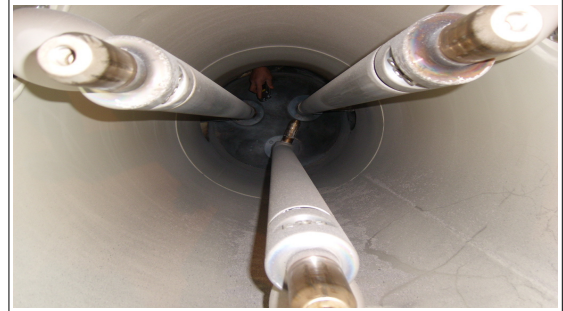
AA-BB#2T/L 인출 Wall bushing 연결 상부Tank 내부도체
