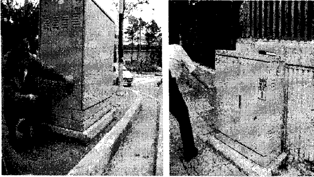
그림 10. 고양시, 천안시 인근 지상변압기 침수 높이 Fig. 10. Flood hight of Pad-mounted Tr at Goyang and Cheonan
