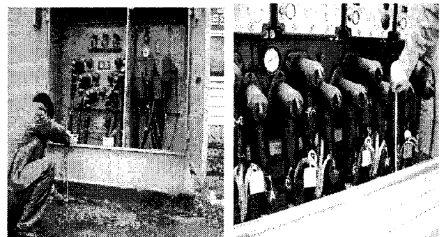
그림 9. 지상 변압기, 개폐기의 지면으로부터 설치 높이 Fig. 9. Installation hight of Pad Tr and Switches
