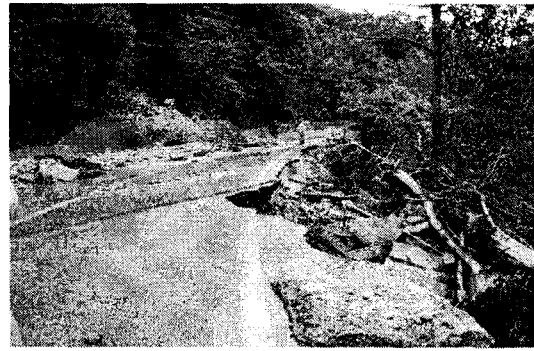
그림 11. 토석류에 의한 도로 파손 및 침하 사례
