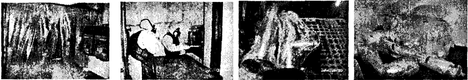
그림 5 필터실 앞에 설치된 비닐 차단막 그림 6 필터뱅크 분해 작업 그림 7 하우스 배관 분리후 1차 포장 그림 8 철거후 최종처분을 위해 보관중인 하우스 및 배관
