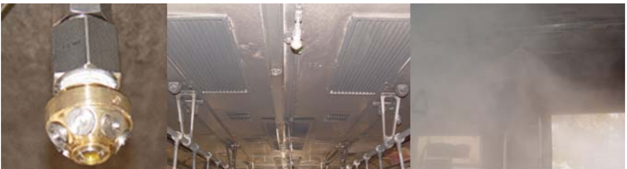
그림 3. 객차 내 설치된 7구경 고압노즐 및 미세 물분무시 장면
