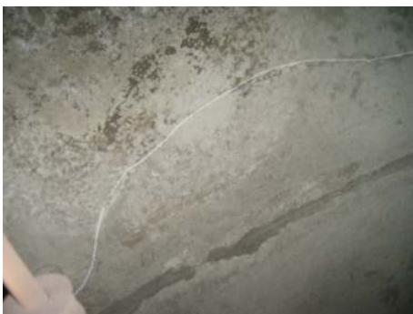
그림 2.1 횡방향 균열(cw 0.2, 16K311 : RS)
