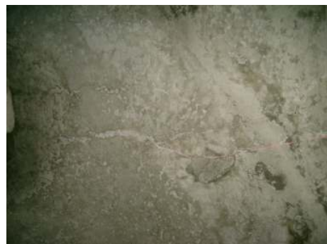
그림 2.2 횡방향 균열(cw 0.1-0.2, 16K323 : RS)
