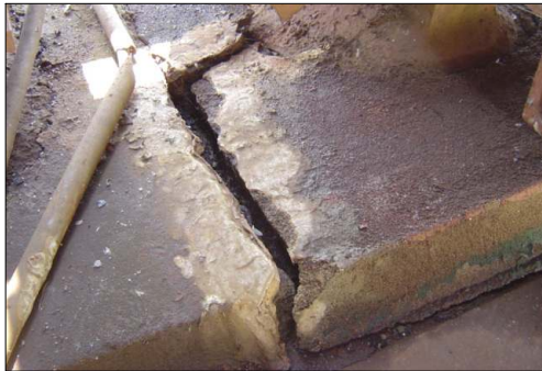
(a) 교량받침 콘크리트 파손
