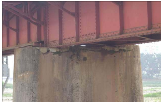
(b) 교각상부 콘크리트 파손
