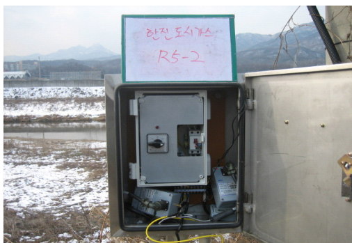
<그림 8> 현장에 설치된 분포형 외부전원시스템의 사진
