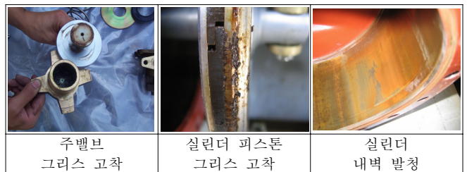
<사진 3-1> 실린더 및 조작부 불량사례
