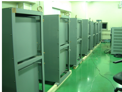
사진 1. 설치된 capacitor bank 모습.
