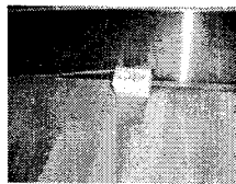
그림 29 콜라텍 바닥에 노출 설치된 콘센트의 일례
