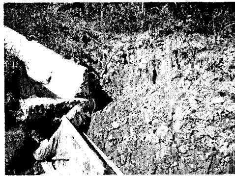
그림 7. 과도한 침식에 의한 산마루측구 붕괴
