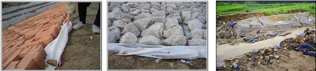
그림 8. 부직포 설치 및 이에 따른 호안공의 부등침하 및 내려앉음 현상
