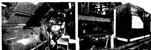
가스엔진 발전(1.5 MW)
