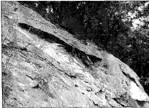
사진 8. 낙석 발생부 측면
