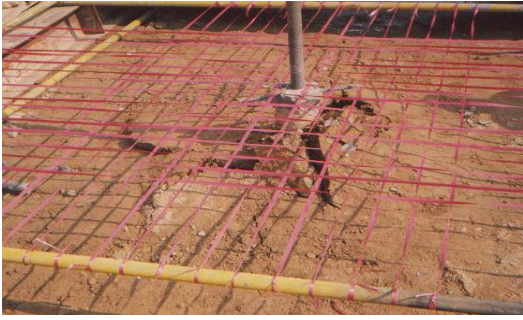
그림 8. 정착길이 2m 일때의 콘크리트 손상
