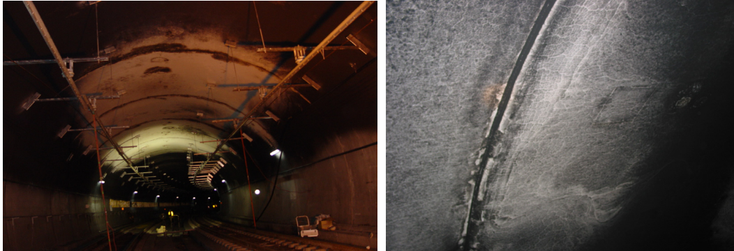
그림 5. 좌 : 온수역 유치선 터널 전경, 우 : 시공이음부 박락
