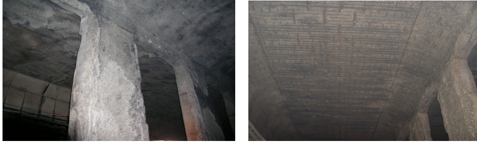
그림 7. 좌 : 기둥부 화상 및 폭열, 우 : 슬라브 폭열 및 철근 노출
