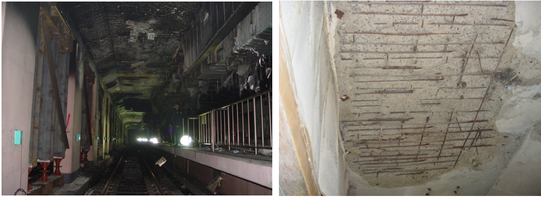
그림 2. 좌 : 중앙로역 화재 전경, 우 : 콘크리트 폭열, 철근노출
