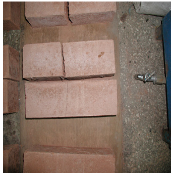
그림 3. 비 보강형 고화토와 보강형 고화토의 균열 비교
