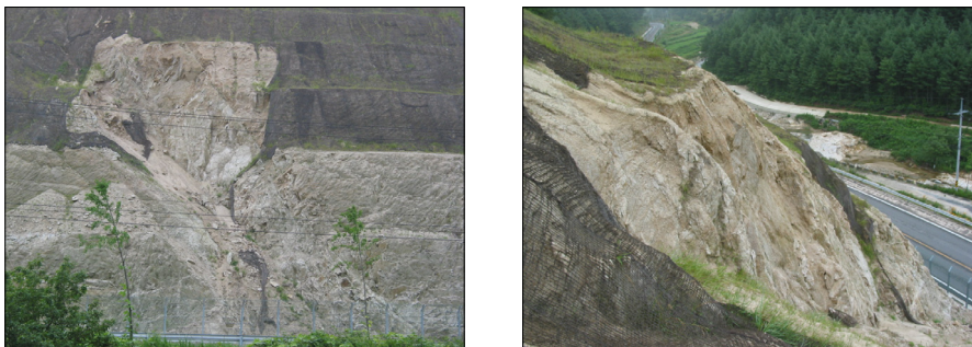
그림 3.2.2 붕괴구간 전면 및 측면
