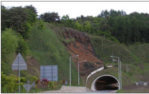
그림 1. 수안보터널 갱구사면 전경
