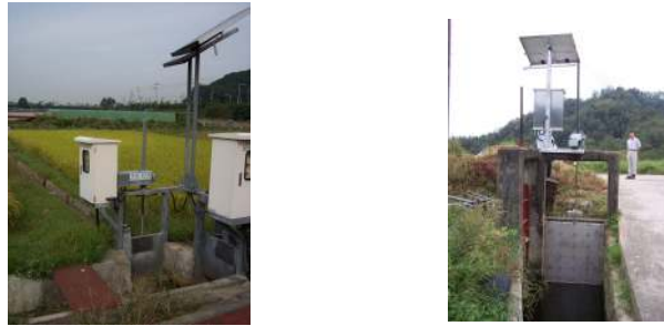
사진 4. 농어촌연구원과 경북 칠곡에 설치된 태양광 전동수문
