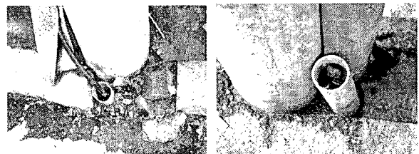
(a) 관구 파손
