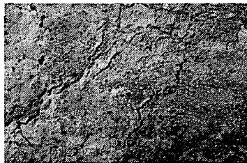
그림 6 팽창제 혼합한 콘크리트 시편의 소성수축 균열 모습
