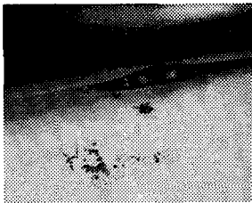
사진 5. 열풍기로 인해 부직포가 타는 현상
