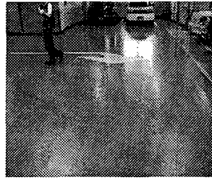
사진 2. 코너부 바닥재 마모
