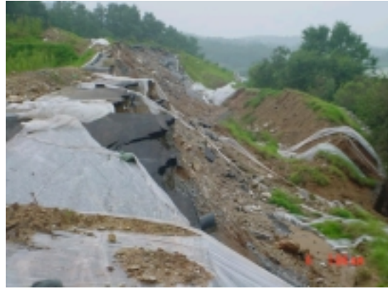
그림 7. 붕괴된 보강토옹벽 전경 2
