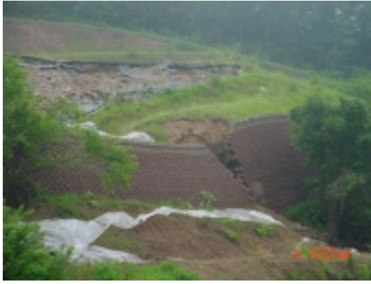
그림 6. 붕괴된 보강토옹벽 전경 1
