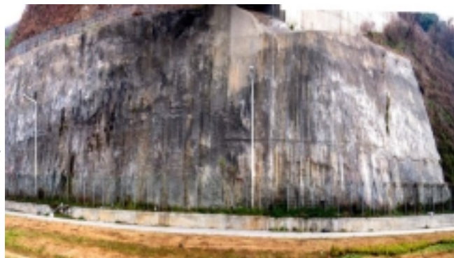
<그림 5> OO선 도로사면 전경
