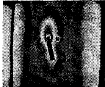
그림 4. 몰드 변압기 외함 균열
