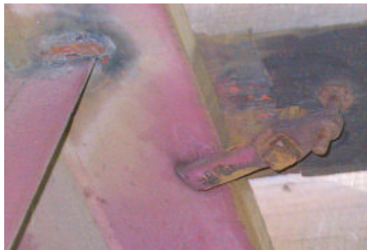
그림7. 수직보강재 용접부 파손
