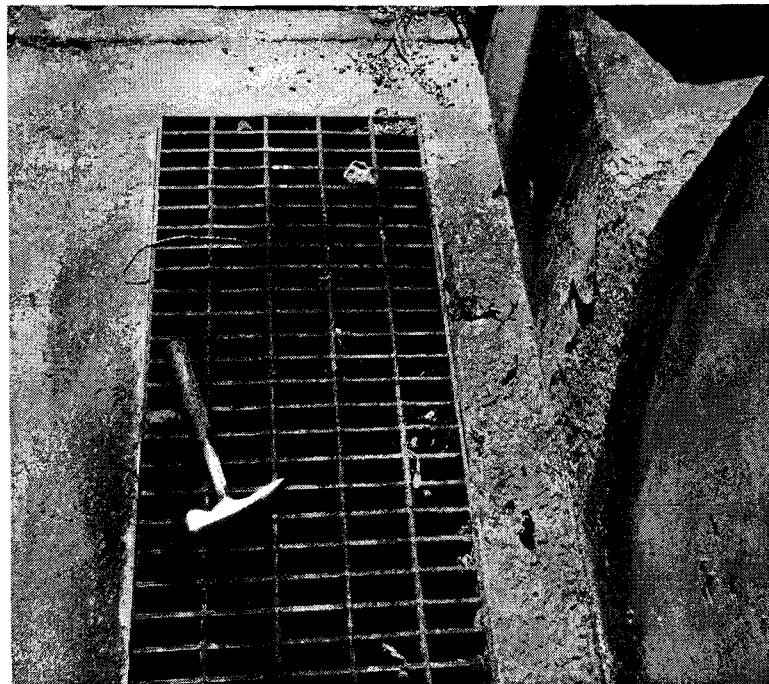
사진 1 도로 절개지 주변 배수시설물의 부식 과 침전물에 의한 미관 훼손 (적화현상)
